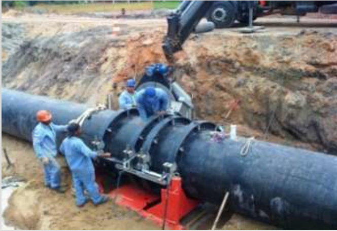
Montagem e Instalação do Emissário subaquático Porto Itaqui – MPX – São Luis /MA
