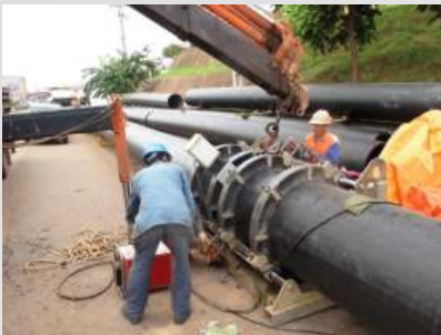
Montagem e Instalação do Emissário Subaquático Porto Itaqui MP São Luís /MA
